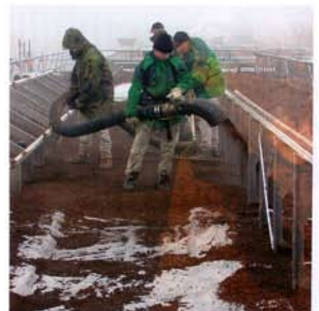
Um Verschmutzungen zu vermeiden, werden die Photovoltaik-Module erst nach dem Aufbringen des Substrates installiert.
