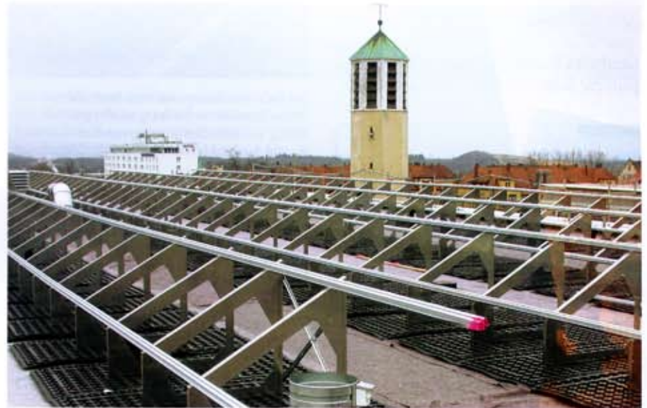
Die Einbindung des Gründach-Systemaufbaus ermöglicht eine durchdringungsfreie Montage der PV-Anlage.
