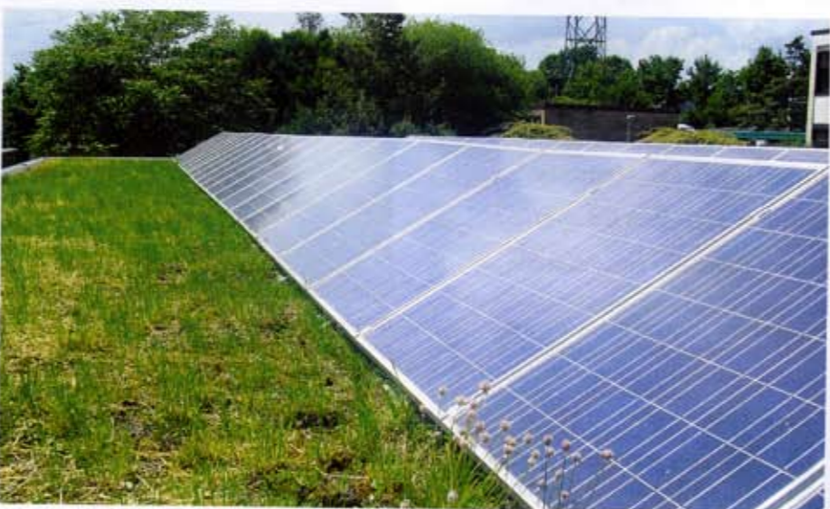
Planungsfehler: Die Unterkante der Solarmodule berührt fast die Pflanzebene. Verschattungseffekte in der Vegetationsperiode sind dadurch vorprogrammiert. Foto: DDV
